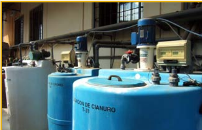
Fig. 27 Reactor de oxidación de cianuros de una depuradora de aguas residuales
