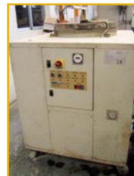
Fig.6 Equipo de frío de un sistema de refrigeración
