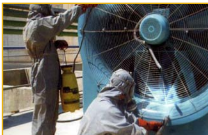
Fig. 20 Operaciones de desinfección de una torre de refrigeración
