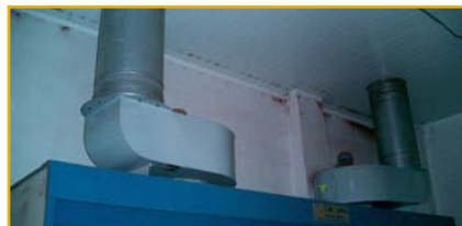
Fig. 43 Extractores de una cabina de lacado
