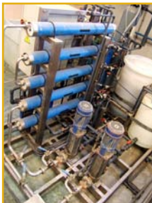
Fig. 32 Instalación de ósmosis inversa para la obtención de agua de calidad a partir de agua de red
