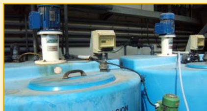
Fig.9 Agitadores de una depuradora de aguas residuales
