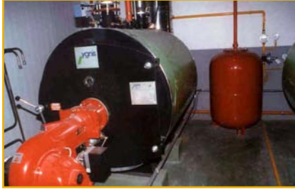
Fig.13 Caldera para calefacción de baños electrolíticos
