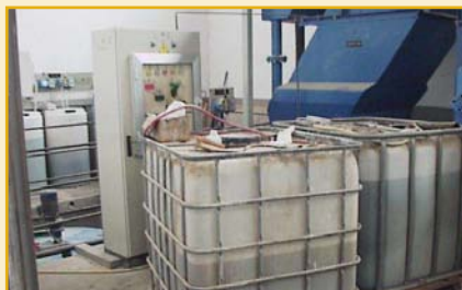
Fig. 29 Concentrados agotados dosificados a una depuradora de aguas residuales
