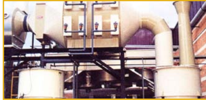
Fig. 36 Instalación de lavado de gases
