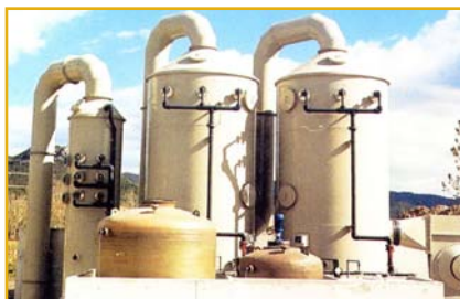
Fig. 30 Instalación de lavado de gases
